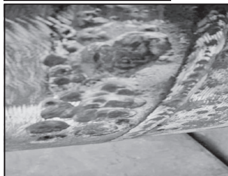
Obr. 2 Rozsiahle korozívne napadnutie potrubia pod podperou (zostatková hrúbka steny 0,9 mm)
