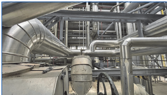
Obr. 8 Potrubný kompenzátor (tzv.lýra) po dispozičnej zmene potrubí
