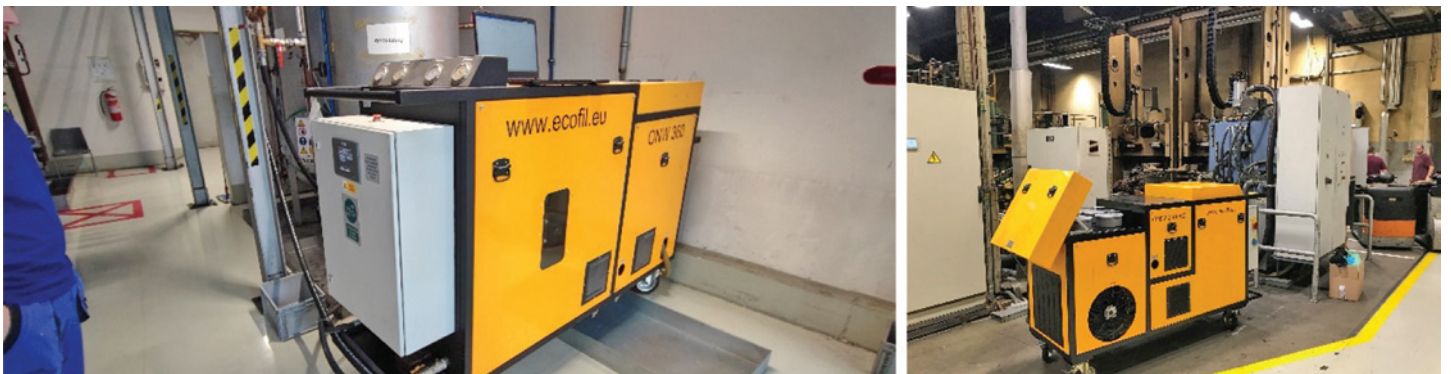
Foto č. 2 Aplikácie vákuových zariadení ECOFIL rady ONW, (zdroj: ECOFIL)
