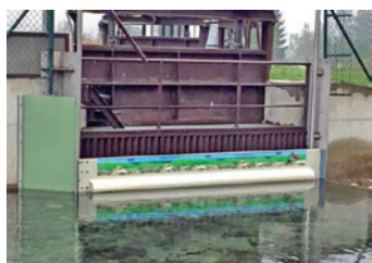
Foto: osadenie na vstup do kanála MVE
