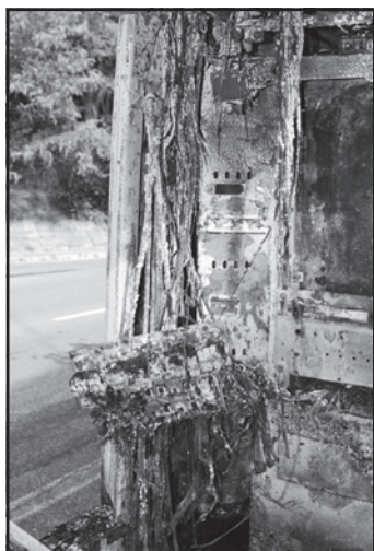
Pohľad na zvyšky elektrických ovládacích prvkov
