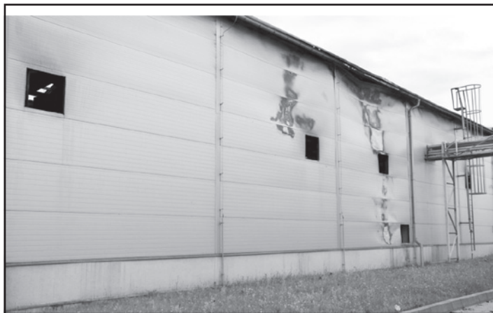
Pohľad na požiarom poškodený obvodový plášť haly
