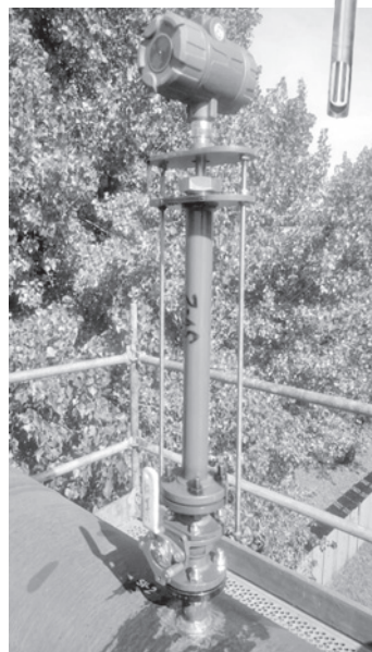
Tepelne-vodivostný zásuvný prietokomer Magnetrol TA-2 s vyberacím mechanizmom inštalovaný spol. Intech Control, spol. s r. o., pre meranie prietoku stlačeného vzduchu.
