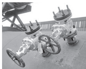
Potrubné porty (návarky) s uzatváracími ventilmi pre zásuvný UZ prietokomer GE inštalované spol. Intech Control, spol. s r.o. na potrubí DN1200 pre zákazníka US Steel Košice, s. r. o.
