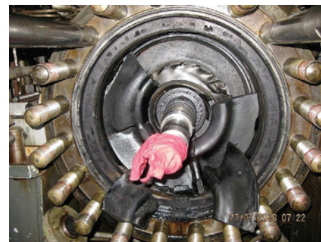
Obr. 9: Stav kompresora po odstránení sacie príruby.
